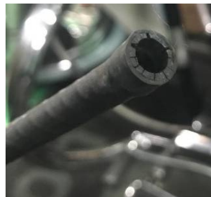
燃料ホースは切断面から硬化劣化します
